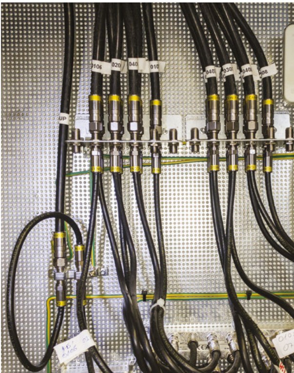
Abbildung 42: HFC-Verteilung mit Multitaps zur Versorgung der WE in Sternverkabelung Quelle: ANGA Der Breitbandverband e. V.
