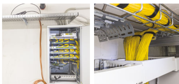
Abbildung 46: Gebäudeverteiler und Einzelfaser-Verteilung über Kabelführungssystem Quelle: willy.tel GmbH
