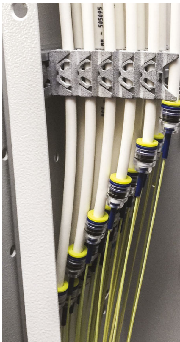
Abbildung 36: Darstellung der Installationsleitung zu den WÜPs Quelle: ANGA der Breitbandverband e. V.
