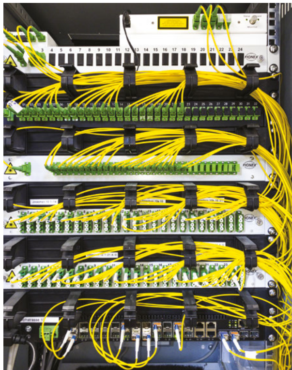
Abbildung 45: Aktiver PtMP-Gebäudeverteiler mit Patchfeldern Quelle: willy.tel GmbH
