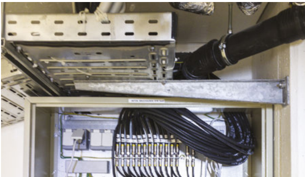
Abbildung 41: HFC-Gebäudeverteiler mit darüberliegendem Kabelführungssystem/Kabelwanne Quelle: Marienfeld Multimedia GmbH
