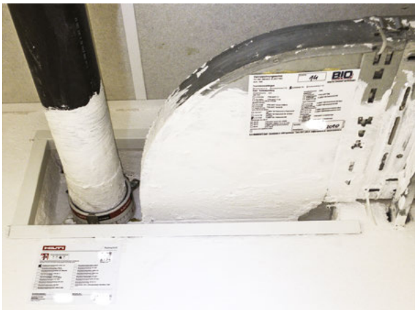
Abbildung 59: Brandschottung für eine Kabelwanne und ein Abflussrohr Quelle: ANGA Der Breitbandverband e. V.
