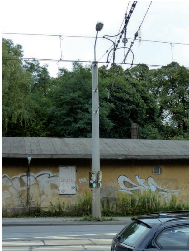
Abbildung 13: Fahrleitungsmast Quelle: Dresdner Verkehrsbetriebe AG
